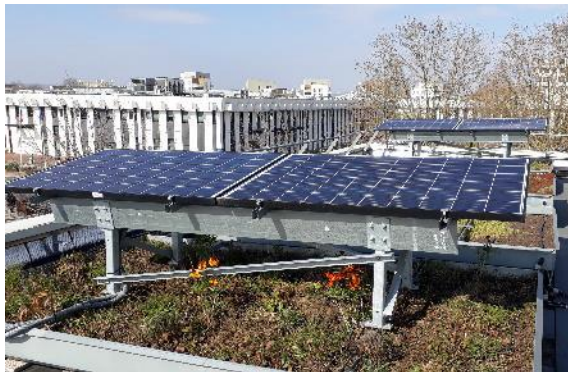
Expérimentation « Toit vert et solaire »
